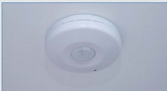
Illuminazione con sensore di movimento
